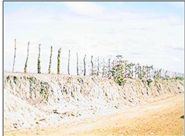
FOTO 8.10 - Corte de estrada que liga as localidades de Estreito a Vieira, em área de afloramento eluvionar de argilas.
