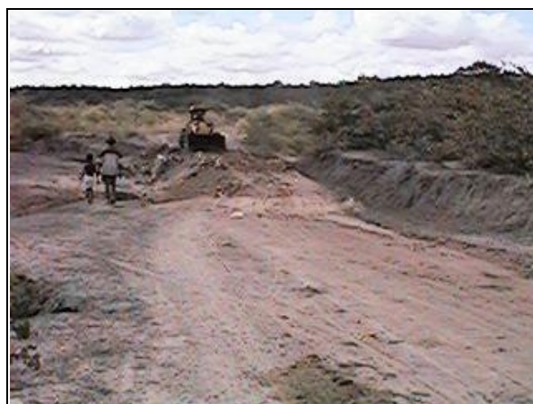
FOTO 8.12 - Estrada de acesso ao Cabeço Branco. Detalhe para as escavações laterais em vertissolos argilosos.
